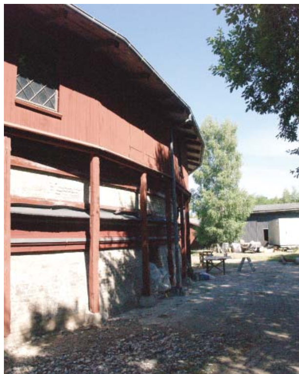
Belægning omkring Nivå ringovn. Istandsæt i løbet af sommeren 2014.
